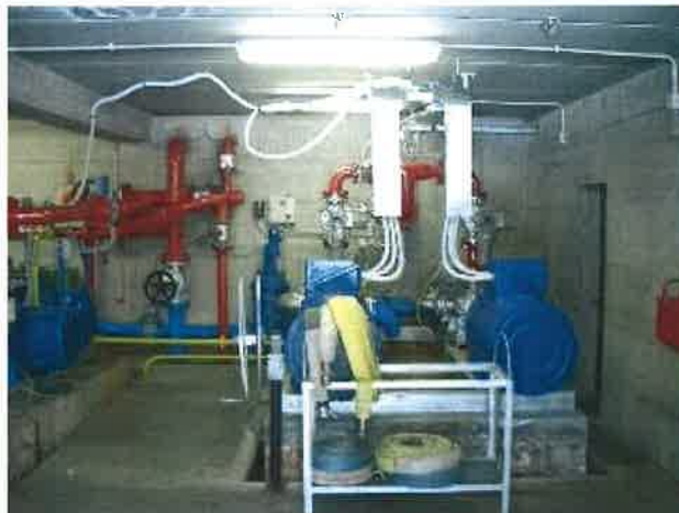
FOTO N. 19 : POMPE INNEVAMENTO ARTIFICIALE
