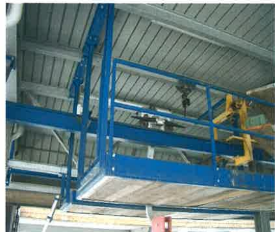
FOTO N. 16 QUATER: PIATTAFORMA RIALZATA PER LA MANUTENZIONE MORSE SEGGIOLINI
