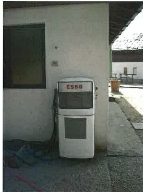
FOTO N. 33: POMPA RIFORNIMENTO GASOLIO
