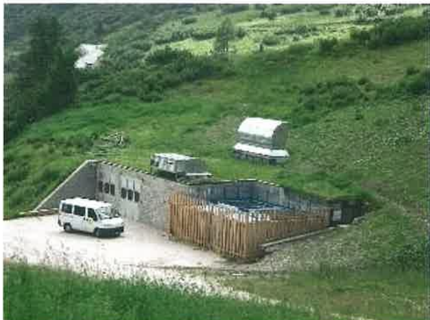
FOTO N. 18: STAZIONE DI INNEVAMENTO E TORRI DI RAFFREDDAMENTO
