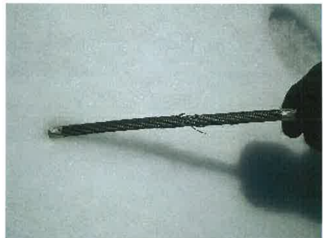
FOTO N. 16 BIS: CONTROLLO DELLE FUNI: NEL CASO SPECIFICO COLPITA DA FULMINE
