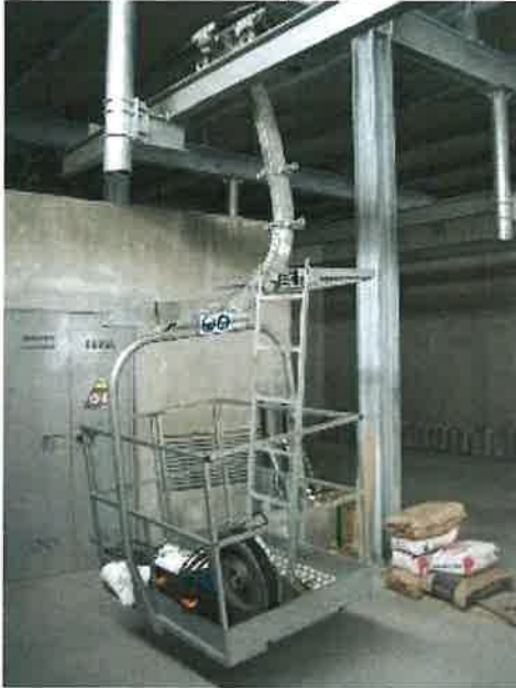
FOTO N. 10: CARRELLO PER LA MANUTENZIONE IN LINEA
