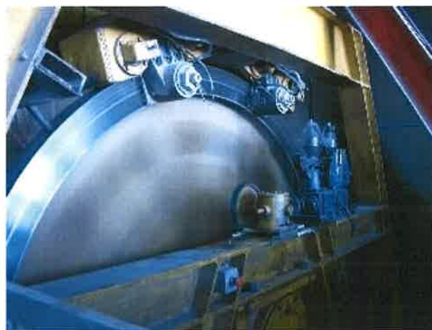
FOTO N. 2: PARTICOLARE FRENI FUNIVIA
