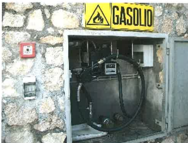
FOTO N. 33 BIS : POMPA EROGAZIONE GASOLIO AUTOMEZZI
