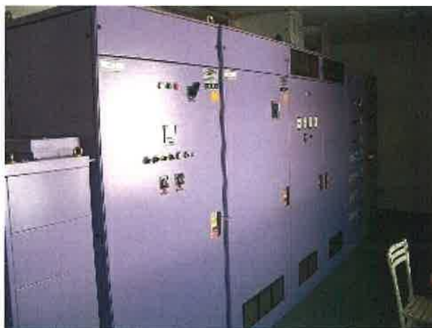
FOTO N. 17: QUADRI ELETTRICI PRESSO LA STAZIONE DI COMANDO
