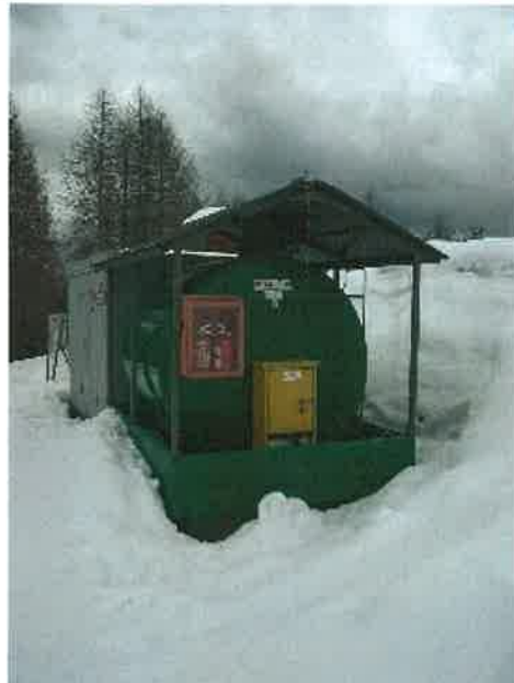
FOTO N. 34 : POMPA E SERBATOIO DI GASOLIO MOBILE
