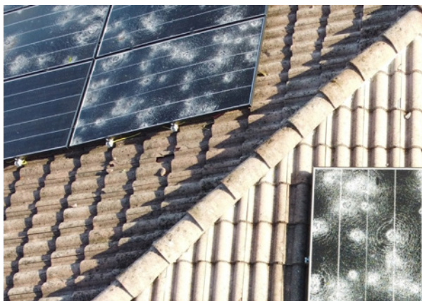
2. Danni all'impianto fotovoltaico
